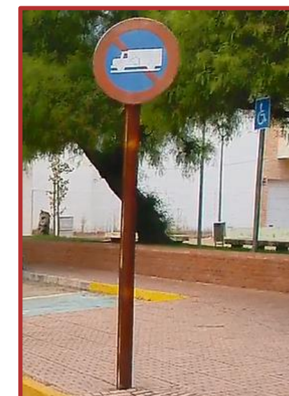
Ilustración 100. Señal descolorida y con óxido en Av. de la Diputació
