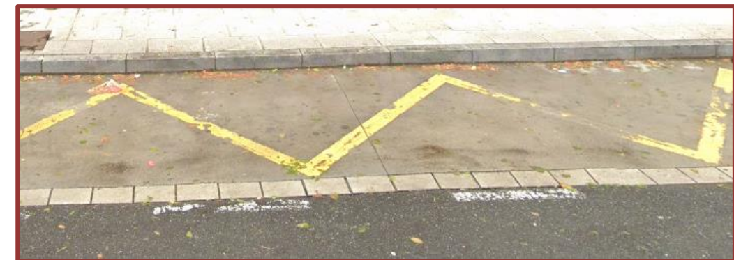
Ilustración 105 Ejemplo de señalización vial en el pavimento
